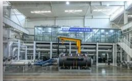
国内最大容量国家级冷水机组实验室
